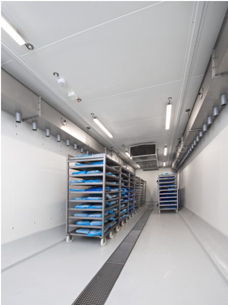
Foto 02 - Interior de la instalación de descongelación VEMAG ANLAGENBAU
